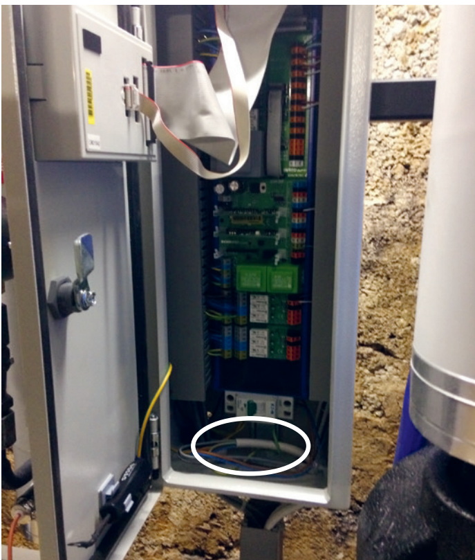
Beispiel vom Standard-Gehäuse mit Regler bei einem einfachem Hausanschluss. Der Reserveplatz unter dem Leitungsschutzschalter ist offen zu lassen.
