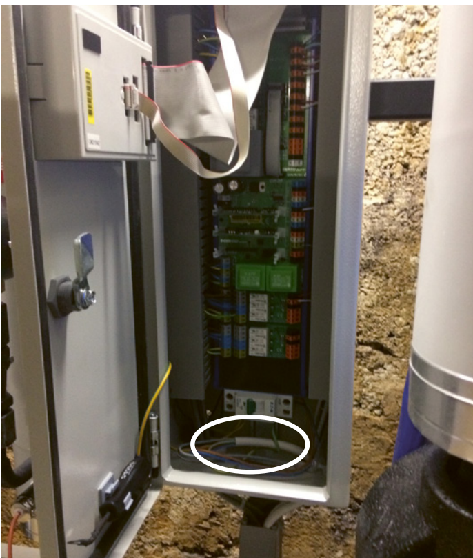
Beispiel vom Standard-Gehäuse mit Regler bei einem einfachem Hausanschluss. Der Reserveplatz unter dem Leitungsschutzschalter ist offen zu lassen.
