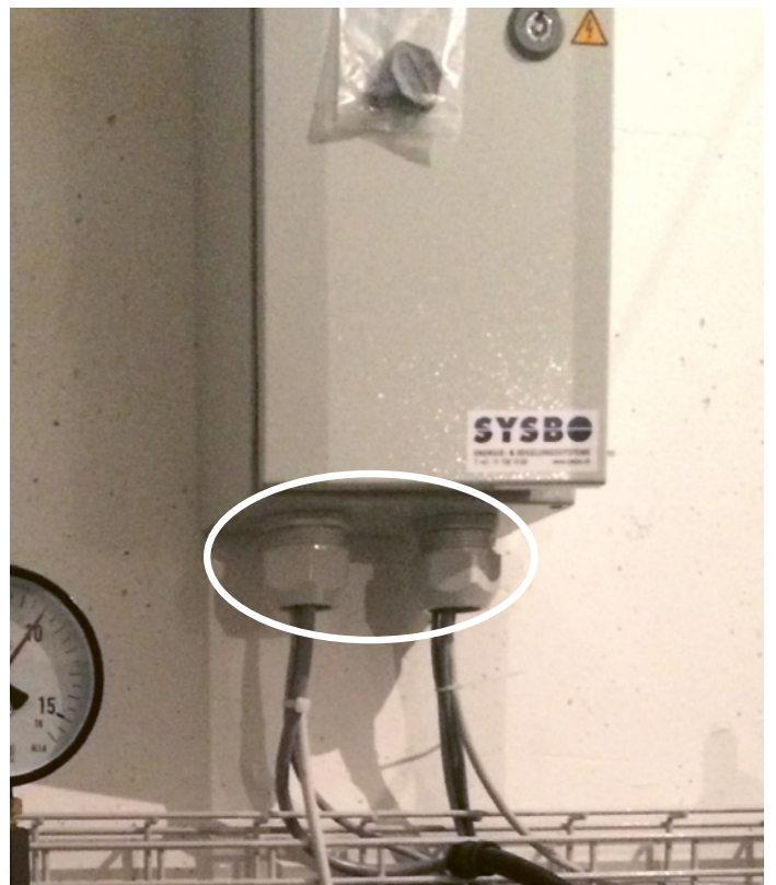
Beispiel einer Kabeleinführung beim Standard-Gehäuse. Platzreserve auf Klemmschiene bei Bedarf! (Erlaubt optimale Platzausnutzung im Gehäuse.)
